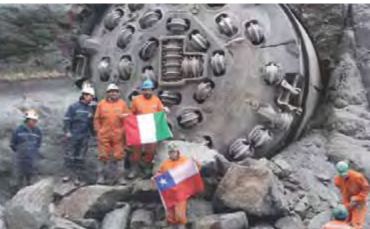
Cile, Impianto idroelettrico di Chacayes.
