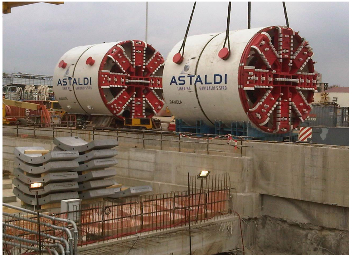
Marzo 2012 – Calo della Talpa meccanica "Daniela" nei cantieri per il prolungamento della Metropolitana di Milano Linea 5 (Italia)
