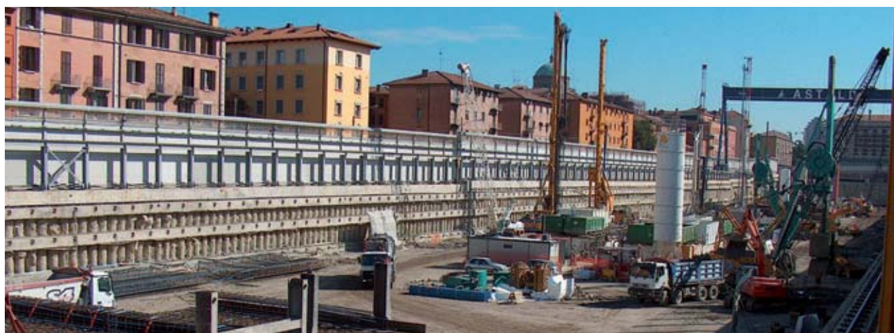
Italia, Stazione Alta Velocità Bologna Centrale.
