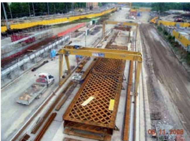
Italia, Stazione Alta Velocità Bologna Centrale.
