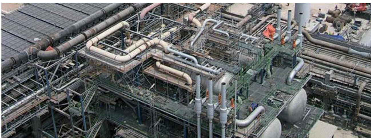
Qatar, Impianto LLDPE di Mesaieed.
